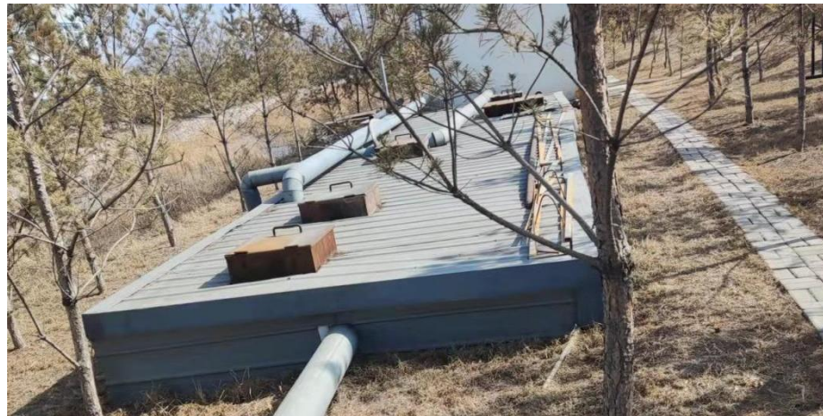
地埋式污水处理站
